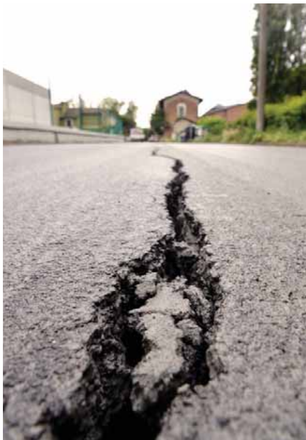
--- Una frattura provocata dal terremoto del 20 maggio a San Carlo, in provincia di Modena ---
